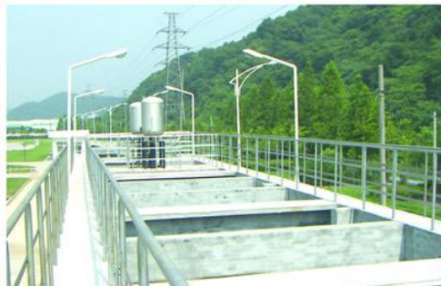
公司生产基地污水处理站扩建增容工程日前完成。该工程使污水处理能力提高了四倍,确保在扩大生产规模的同时绿色环境不受影响。图为试运行中的污水处理站。
